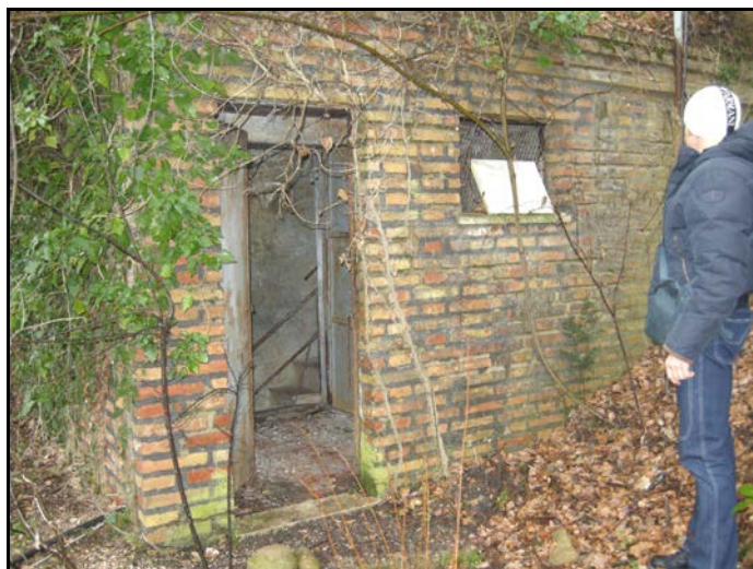
Foto 59 - Opera di captazione (pozzo) in loc. S. Angelo
