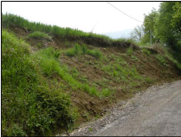
Foto 44 - Piccola frana di scorrimento rotazionale (scarpata stradale, loc. Vaglie)
