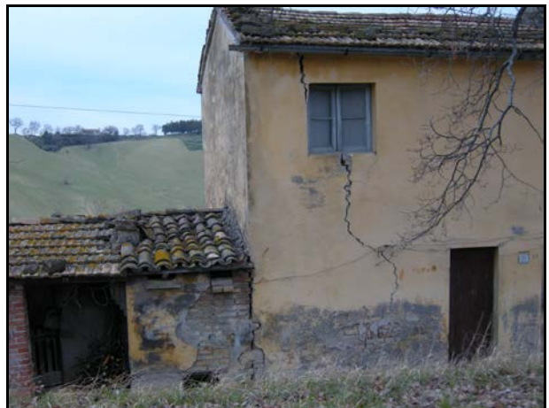
Foto 38 - Edificio colonico gravemente lesionato (loc. Regnano)
